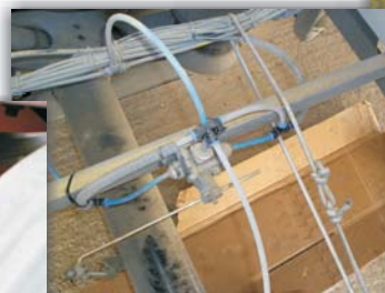
Conductos de aire
